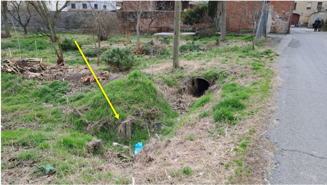
Foto n.2 : Cavo Monteregio lungo via Oberdan (con la freccia è indicato un incastro)
