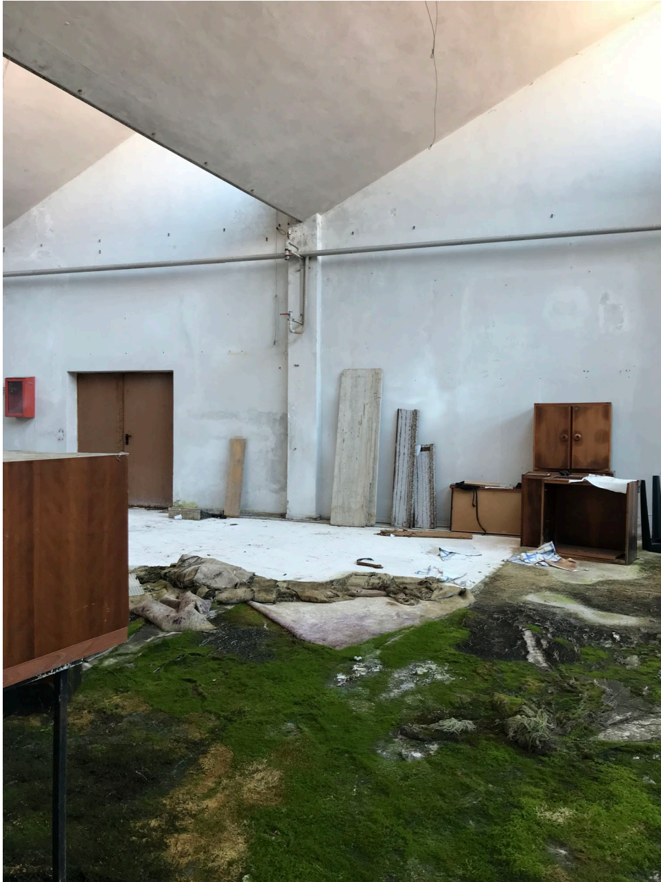
Ripresa fotografica dello stato di degrado dell'interno dell'area Ex-Mirsa
